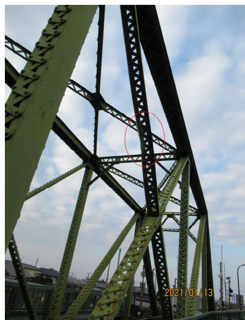
写真－13 爆撃によるトラスの変形
