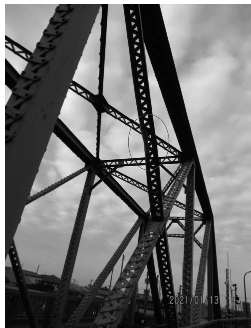
写真－ 13 爆撃によるトラスの変形
