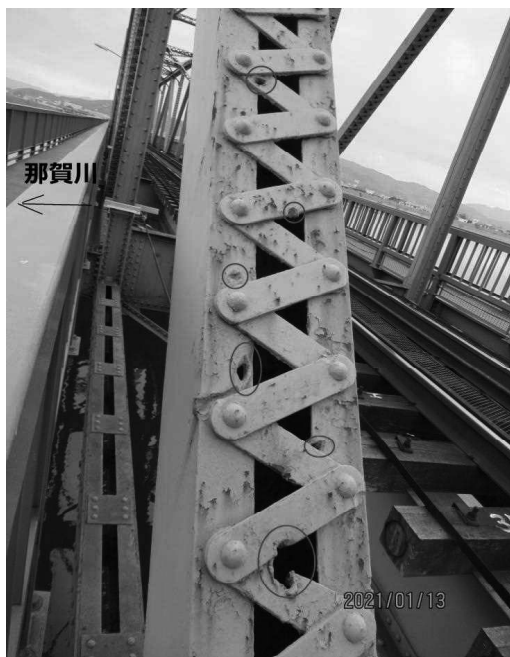
写真－ 12 機銃掃射による銃弾痕跡
